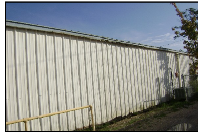
DAMAGED GUTTERS N.T.S. A A1|A2
