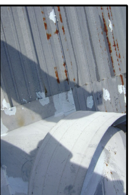
DAMAGED VENTILATOR BASE N.T.S.
