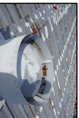
DAMAGED VENTILATOR N.T.S.
