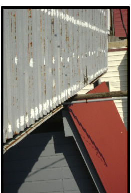
MISSING GUTTER N.T.S.
