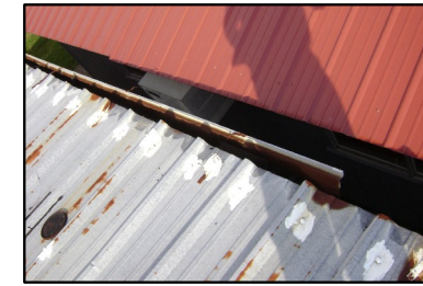
CORRODED GUTTERS N.T.S. H A1|A2
