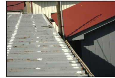
MISSING GUTTER N.T.S. D A1|A2
