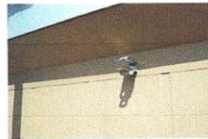
Rear - Condenser Unit Conduit
