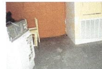
ir Handler Enclosure - Moistur
