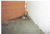
ir Handler Enclosure - Residu
