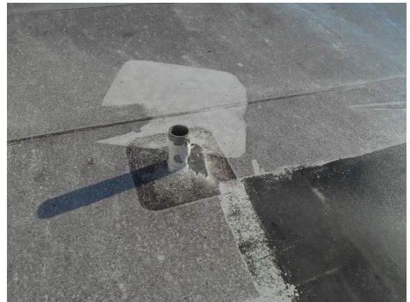
52. PVC vent pipe
