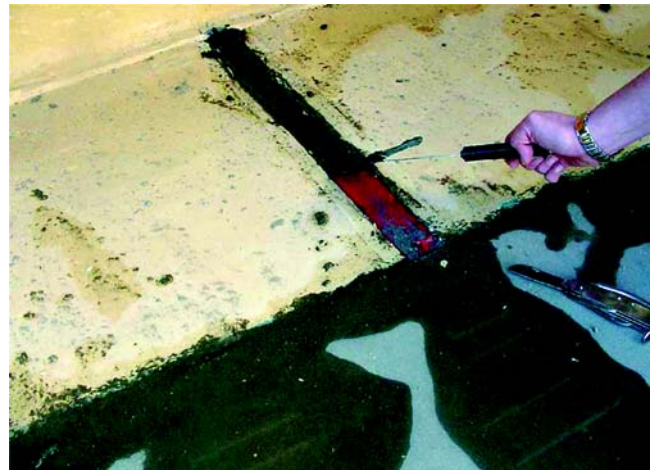
Fig. 2.2.13.2—Joint sealant failure.
